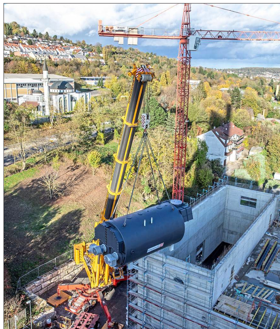
DAS „GESICHT“ VERSCHWINDET IM NEUBAU: Der neue Spitzenlastkessel wird eingehängt, wie es im Fachjargon heißt. Foto: Roth
